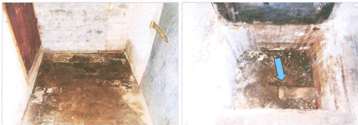
Fot. nr 9, 10. Piwnica – zawilgocona posadzka korytarza i ceglana studzienka z rewizją kanalizacji deszczowej (odprowadzenie wody opadowej z tyłu budynku w kierunku kolektora deszczowego zlokalizowanego w osi ulicy).
