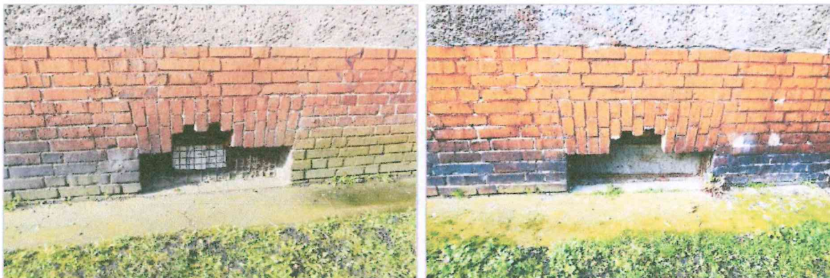
Fot. nr 18, 19. Cokół od strony podwórza – uszkodzone ceglane nadproża, otwory okien piwnicznych szczelnie zabezpieczone różnymi materiałami.
