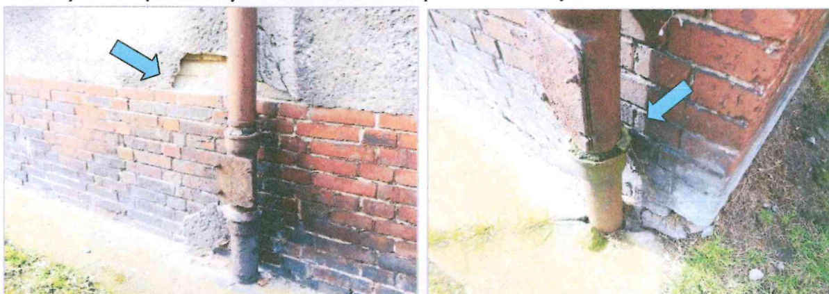
Fot. nr 20, 21. Cokół od strony podwórza - w sąsiedztwie rury spustowej opuchnięcia i odspojenia tynku. Na fot. nr 21 strzałka wskazuje silne zawilgocenia na łączeniu rur świadczące o niepełnej drożności kanalizacji deszczowej. Rury spustowe włączone są do miejskiego kolektora deszczowego.
