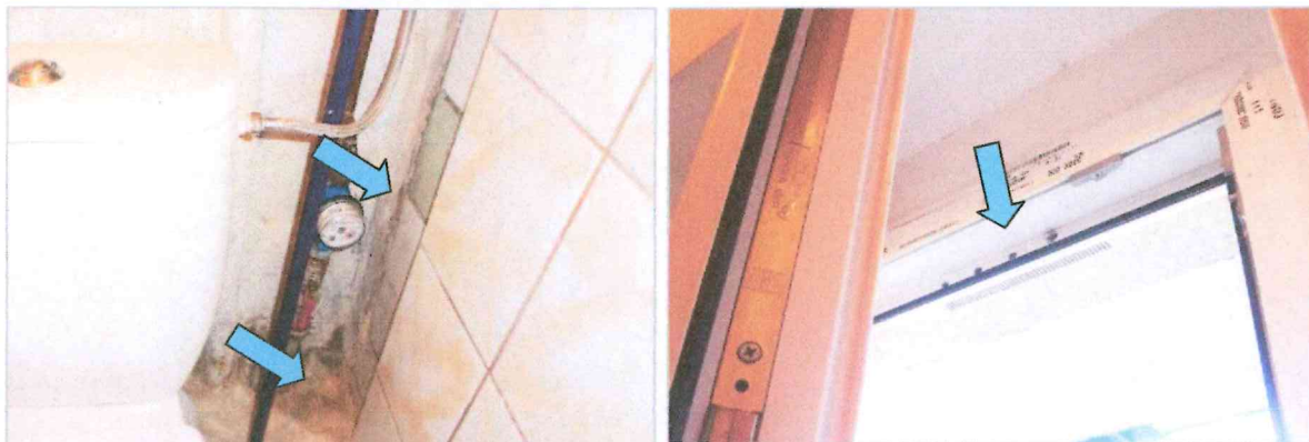
Fot. nr 7, 8. Łazienka w mieszkaniu nr 7 - naloty pleśniowe na ścianie zewnętrznej i niewłaściwy montaż nawiewnika (mała ilość otworów w ramie okiennej).
