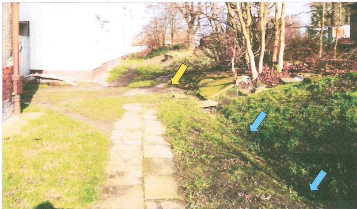
Fot. nr 22. Rów o nawierzchni z cegły klinkierowej mający za zadanie odwodnienie wyżej położonego terenu, w wielu miejscach uszkodzony mechanicznie oraz niedrożny z powodu ziemnych zanieczyszczeń i roślinności. Żółta strzałka wskazuje lokalizację wpustu deszczowego.
