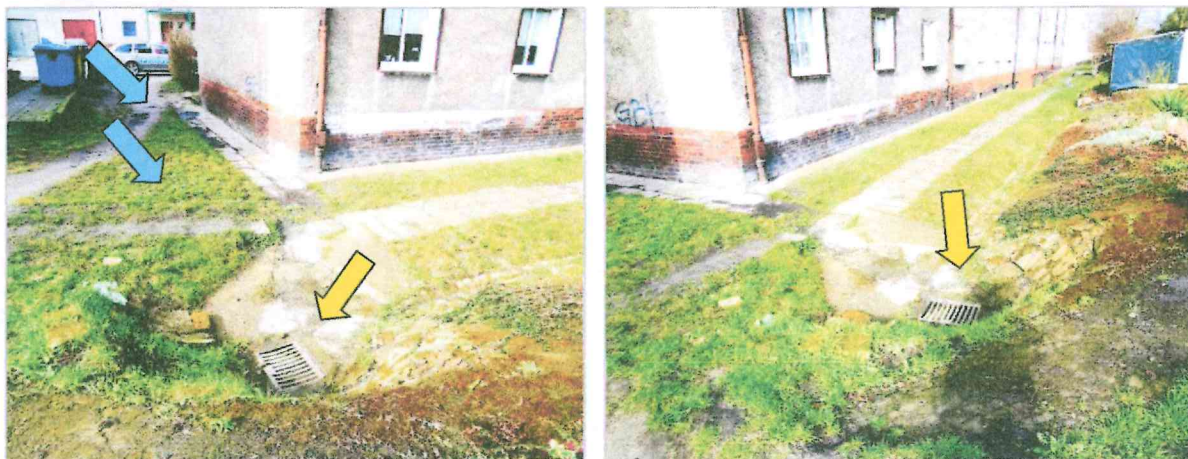
Fot. nr 23, 24. Rów odwadniający – widok od strony płd.-zach. Strzałki wskazują jeden z dwóch wpustów deszczowych z odstojnikiem oraz brak odwodnienia terenu od strony ściany szczytowej.
