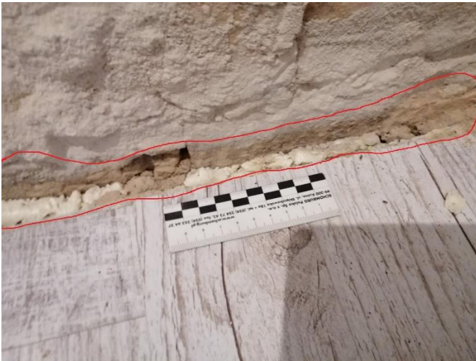
Fot. 15 obszar zawilgocenia tynku anhydrytowego
