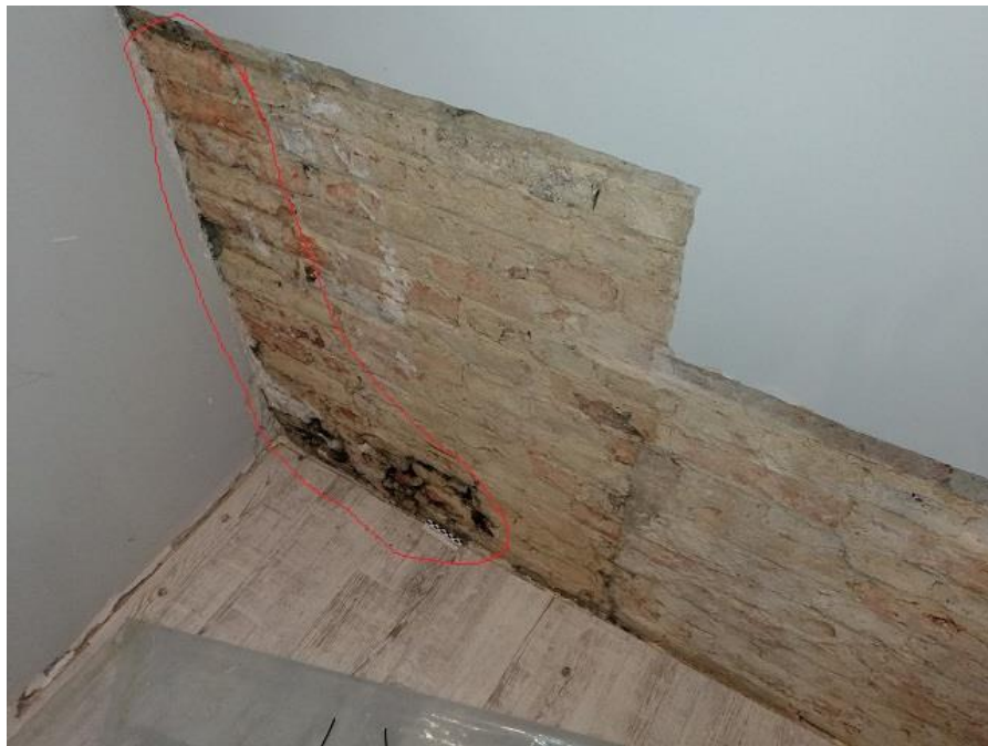
Fot. 17 Skażenie ściany siarczanami w ciągu kominowym
