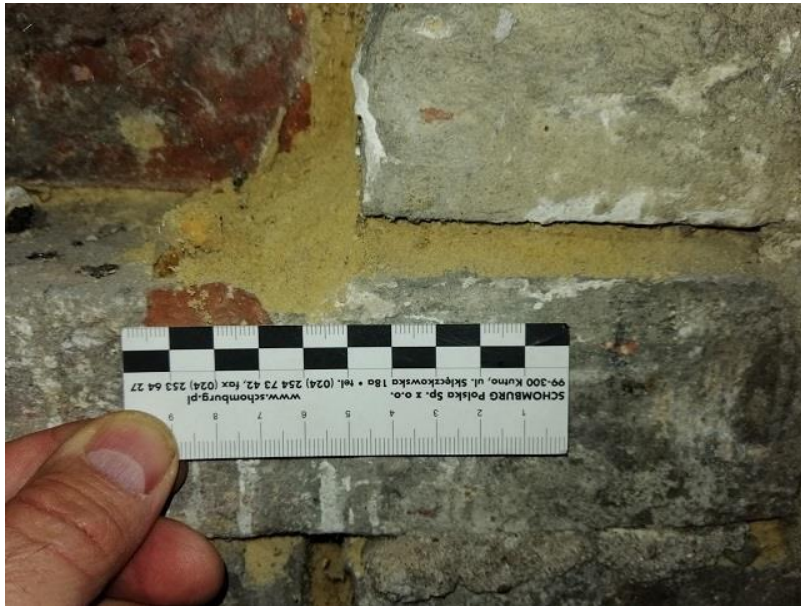
Fot. 9 Uszkodzenia zaprawy murarskiej
