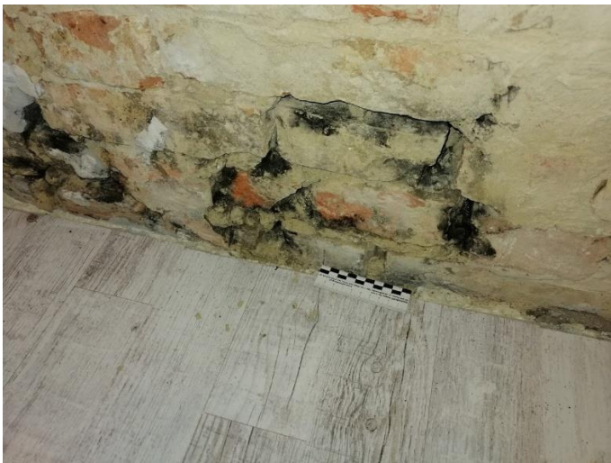
Fot. 18 Uszkodzenia ściany siarczanami
