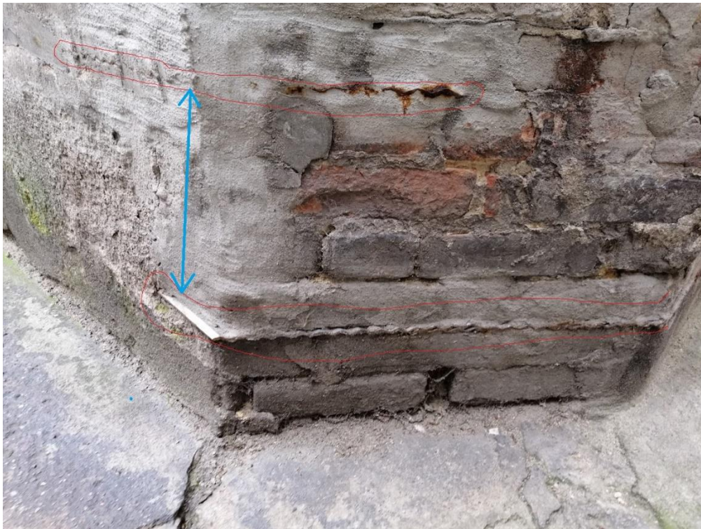
Fot. 4 Blachy osadzone na różnych poziomach oraz widoczna korozja
