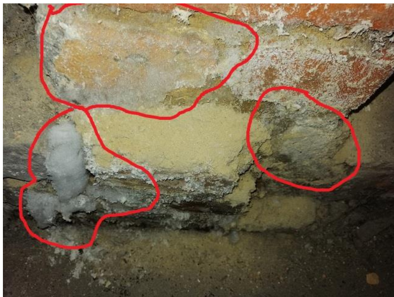
Fot.10 Sole widoczne na konstrukcji ścian fundamentowych
