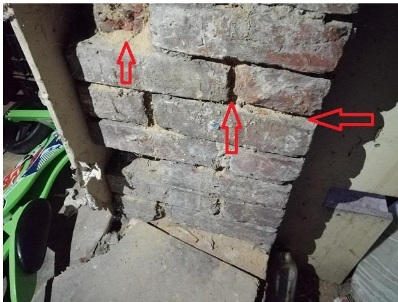
Fot. 8 Uszkodzenia w konstrukcji ścian
