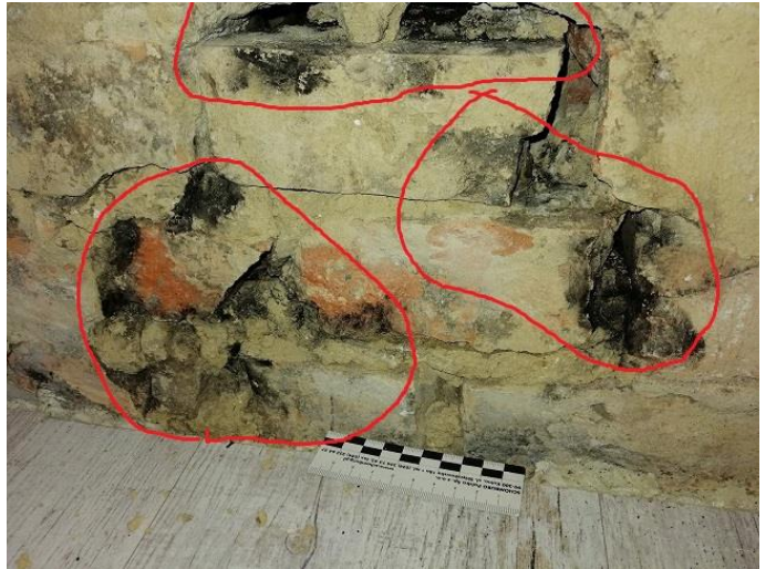
fot. 19. Uszkodzenia ściany siarczanami
