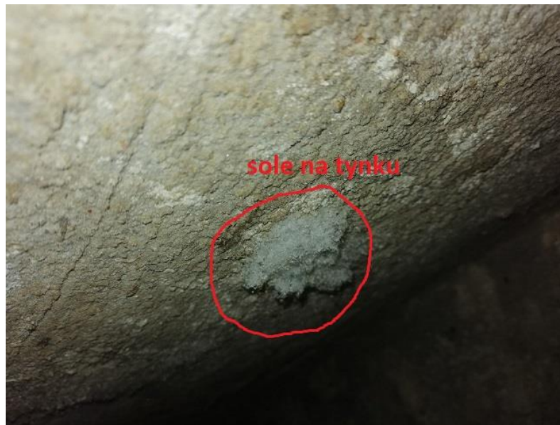
Fot. 11 Kryształły soli na powierzchni tynku
