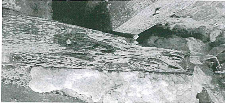
Fot. 1 uszkodzona płatew lukarny
