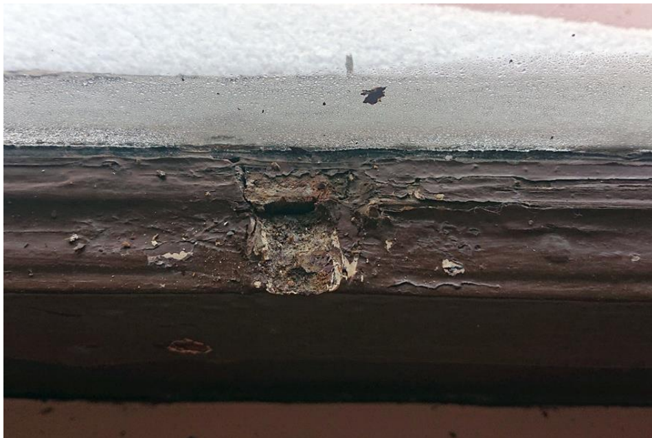
Fot.4. Stan zachowania drewna / ubytki, warstwy malarskie/.
