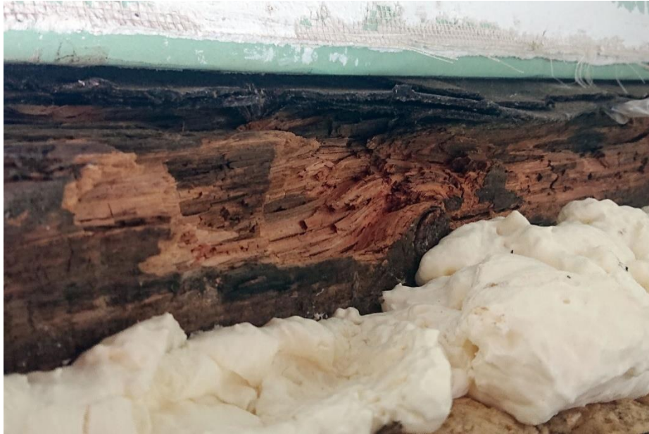
Fot.3. Uszkodzenie drewna spowodowane przez drewnojady.
