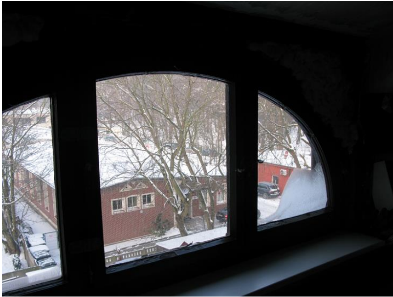
Fot.1. Stolarka od strony pomieszczenia.
