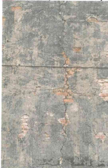
15 Widoczne pęknięcie muru na połowie wysokości elewacji.
