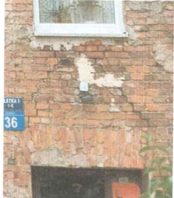
3 Widoczne pęknięcia muru nad nadprożem okna.
