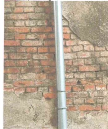
19 Ubytki w spoinach muru, ubytki cegieł.
