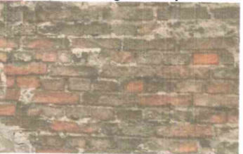
18 Ubytki w ceglach i spoinach muru.
