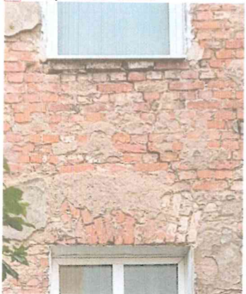
7 Widoczne pęknięcia muru nad nadprożem okna.
