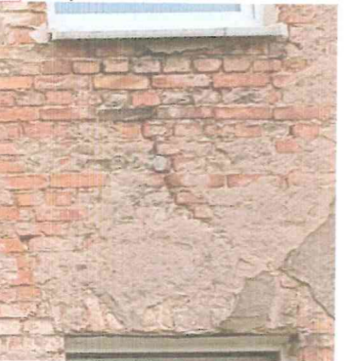
9 Ubytki w murze wokół okna.
