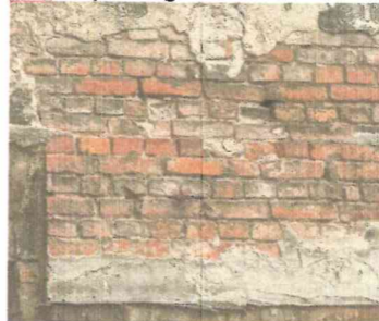
20 Ubytki w spoinach muru, ubytki cegieł.
