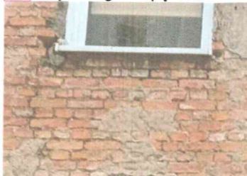
12 Ubytki w spoinach muru, ubytki cegieł i spękania.
