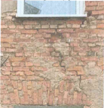
13 Widoczne pęknięcia muru nad nadprożem okna.
