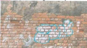
16 Ubytki w ceglach i spoinach muru.
