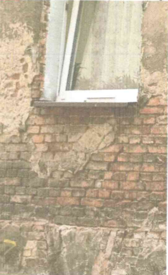
17 Widoczne pęknięcia muru nad nadprożem okna piwnicznego.
