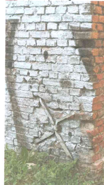
21 Ubytki w spoinach muru oraz liczne ubytki cegieł.
