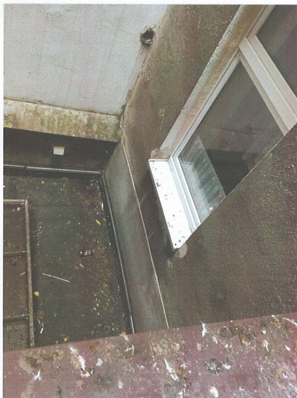
Fot. 3. Wschodnia wnęka z widocznymi licznymi odchodami gołębi.
