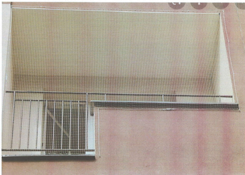
Fot. 6. Przykładowy sposób zabezpieczenia balkonu poprzez montaż siatki.
