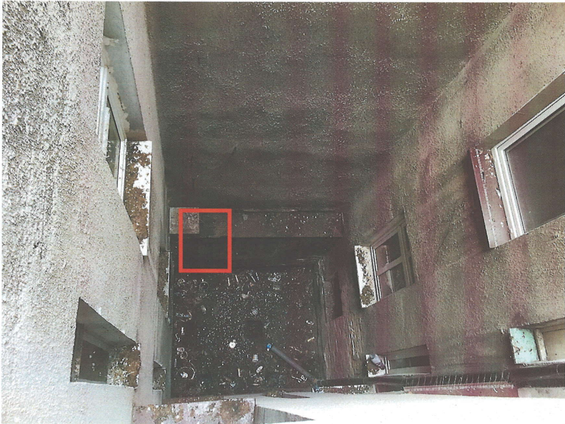
Fot. 4. Zachodnia wnęka z widocznymi licznymi odchodami gołębi na parapetach okien i budkę/karmnikiem.
