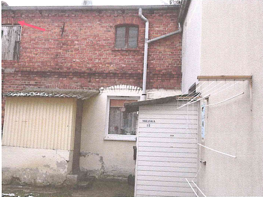
Uszkodzenia ściany Miejska 2A, uszkodzone nadproże ceglane łukowe.
