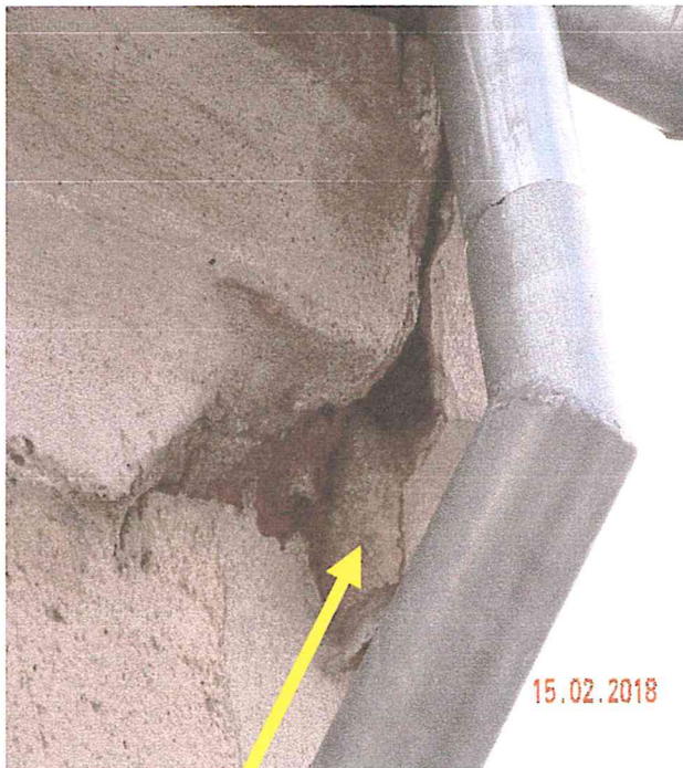
Szczelina pomiędzy murem a dociepleniem ze styropianu
