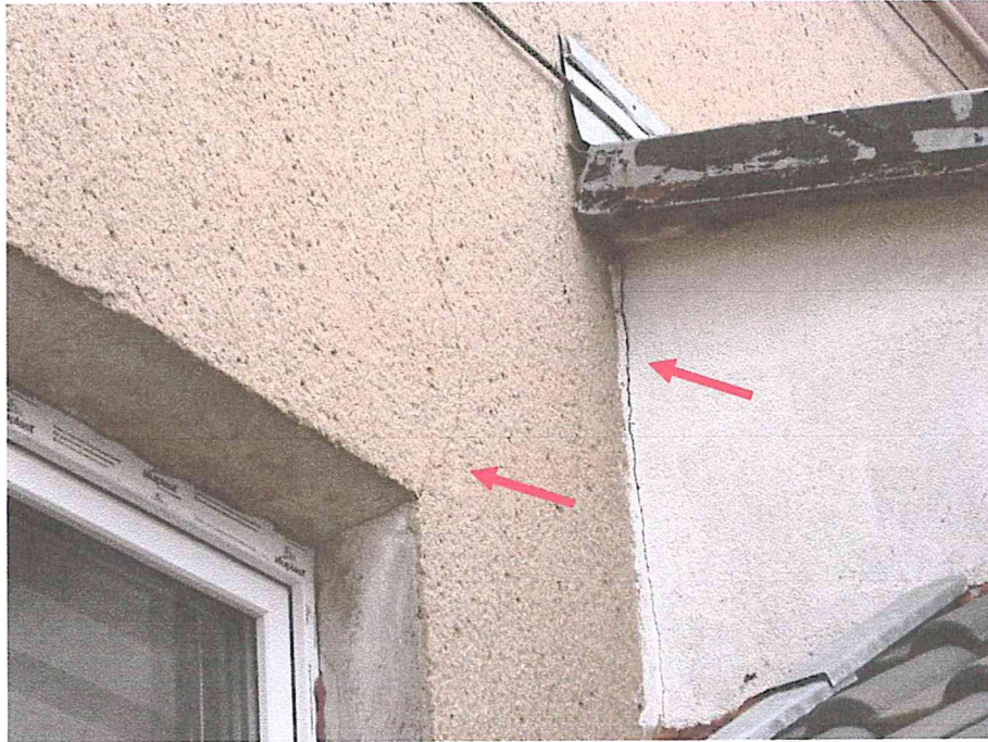
Uszkodzenia ściany Miejska 2.
