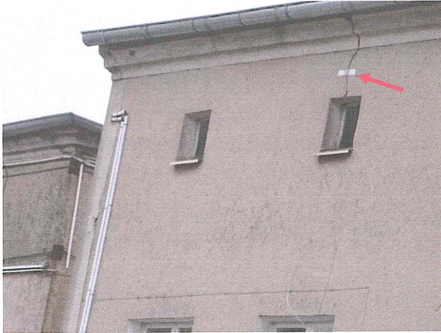
Uszkodzenia ściany Miejska 2a. Widoczna założona plomba szklana – nie uszkodzona. Pęknięcie gzymsu i ściany do linii okien.
