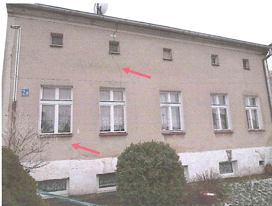
Zarysowania ścian Miejska 2A.
