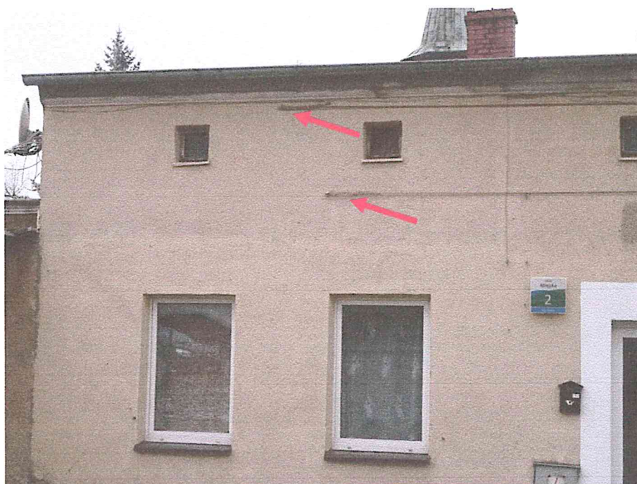
Uszkodzenia ściany Miejska 2. Ślady po wykonanych naprawach rys. Widoczne mocowanie ściągów, w celu wzmocnienia murów.
