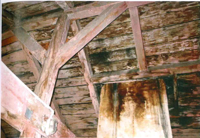
Widok zacieków i zagrzybienia połaci dachu, wymianu i ścian komina
