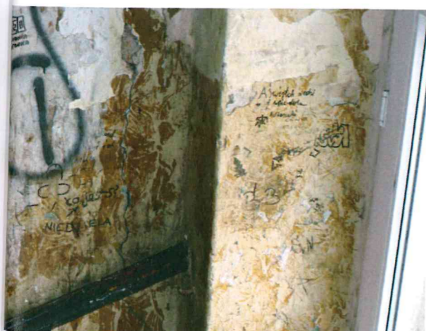
3 ściana przy połączeniu ściany klatki schodowej i ściany zewn.
