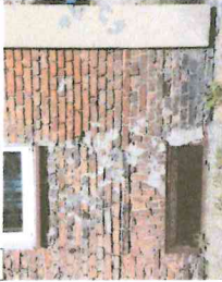
33 Ubytki cegieł i spoinowania.
