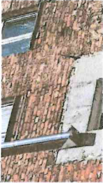
28 Pęknięcia muru, ubytki cegieł.
