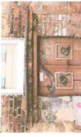
43 Odsłonięte, skorodowane belki stalowe, obróbka blacharska do wymiany.
