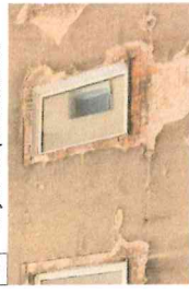
42 Ubytki w spoinowaniu.
