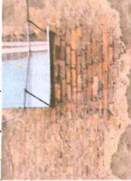
51 Ubytki cegieł w murze, ubytki w spoinowaniu.
