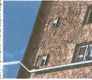
27 Pęknięcia muru, ubytki cegieł.
