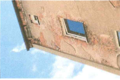
34 Ubytki cegieł w gzymsie, pęknięcia muru.
