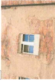
37 Ubytki w spoinach muru.
