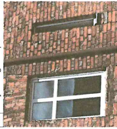
25 Ubytki cegieł i spoinowania.
