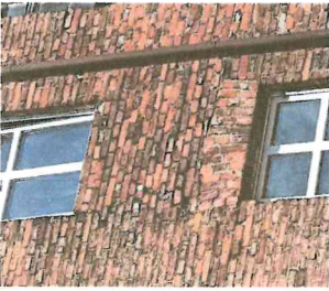
24 Pęknięcia muru, ubytki w spoinach muru.
