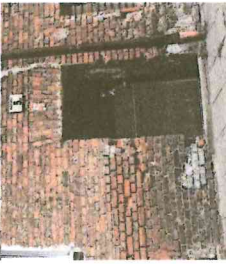
26 Ubytki cegieł w murze, ubytki spoinowania.
