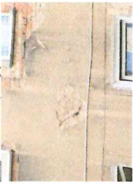
39 Pęknięcia muru, kłamra spinająca.
