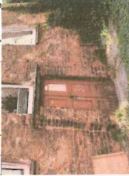
53 Pęknięcia muru, ubytki w spoinach muru, ubytki cegieł.
