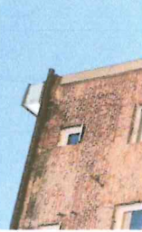
54 Ubytki w spoinach muru, ubytki cegieł w gzymsie.
