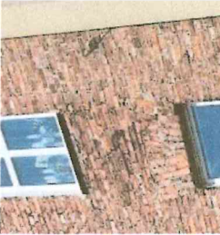
31 Pęknięcia muru, ubytki w spoinach muru.
