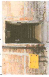
41 Ubytki cegieł w murze.
