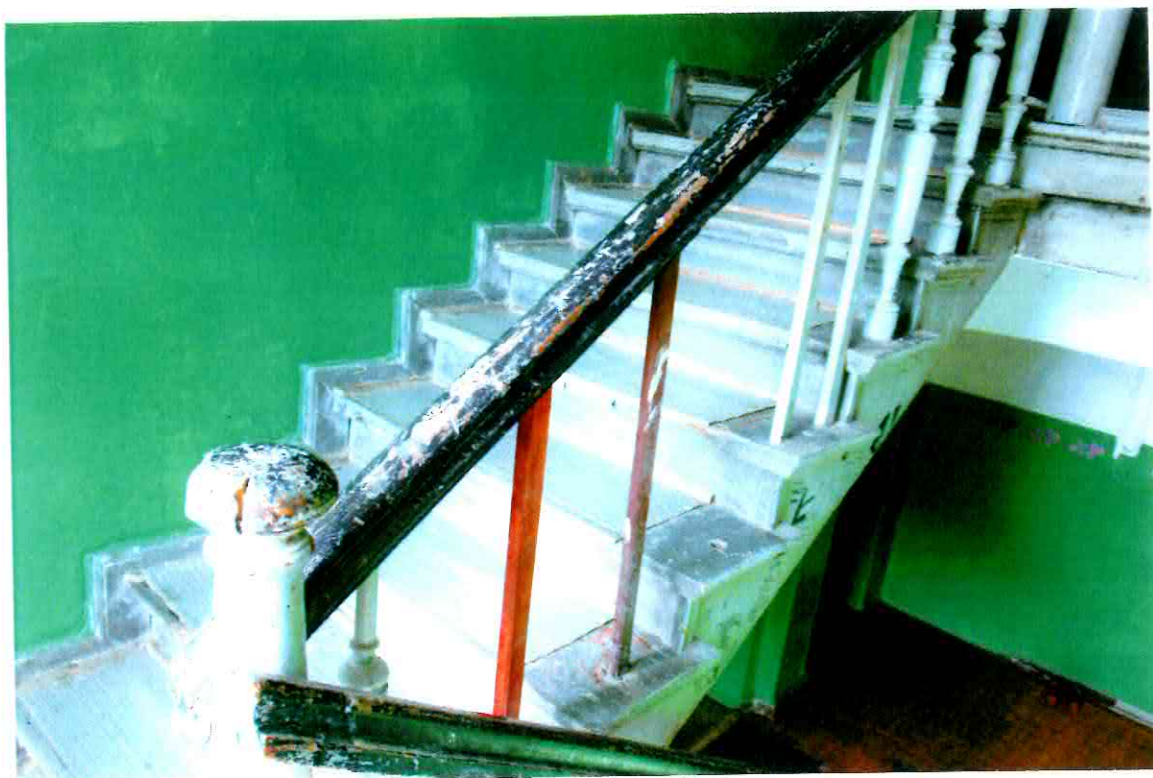
Fot. 22. Wymagające wymian nakładki stopni i podestów oraz uzupełnień brakujących szczelin balustrad
