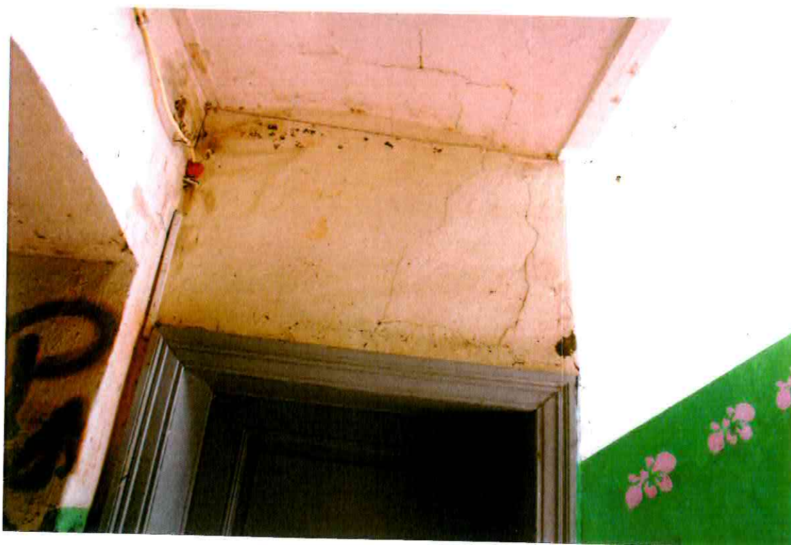
Fot. 11. Zarysowania partii nadprożowych przy wejściu z klatki schodowej do mieszkań
