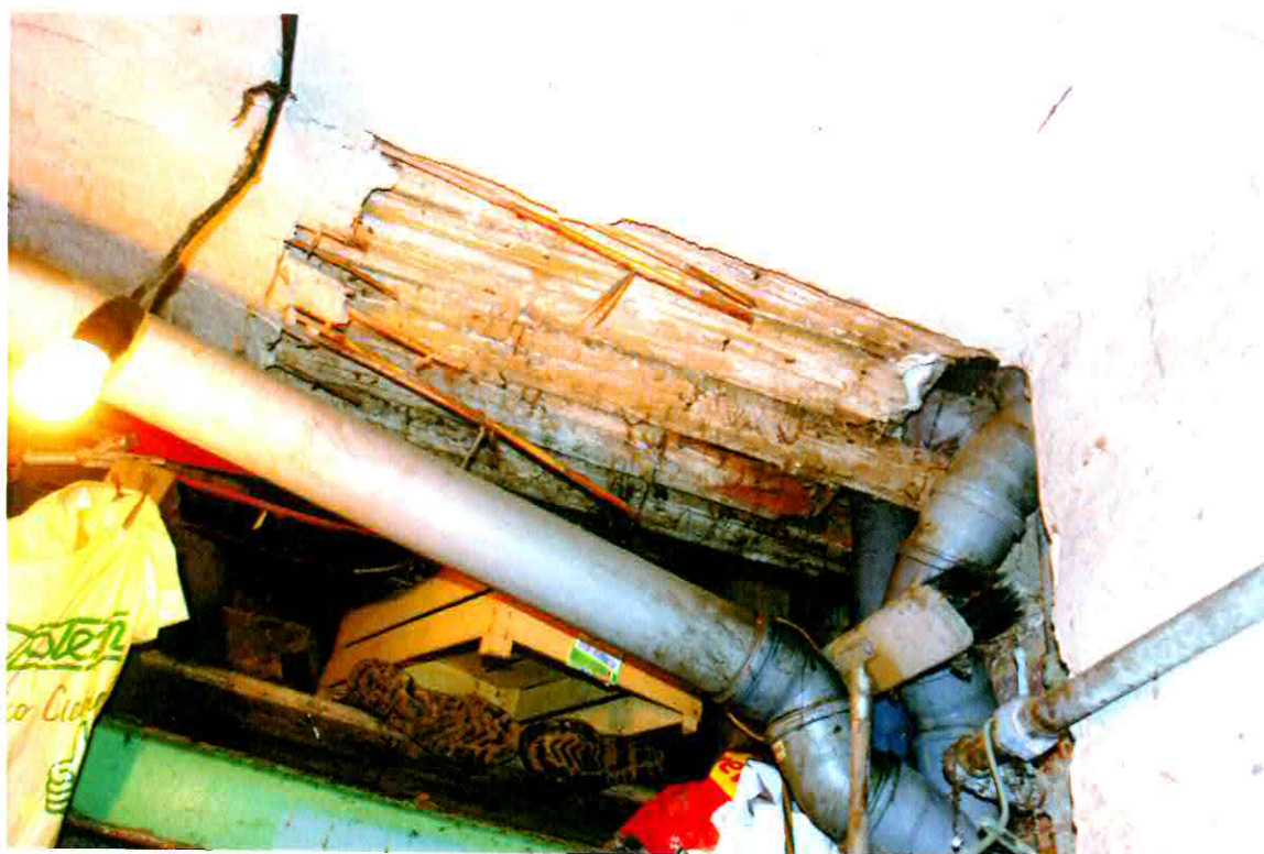
Fot. 19 Uszkodzenie podsufitki nad jedną z komórek lokatorskich w piwnicach .
