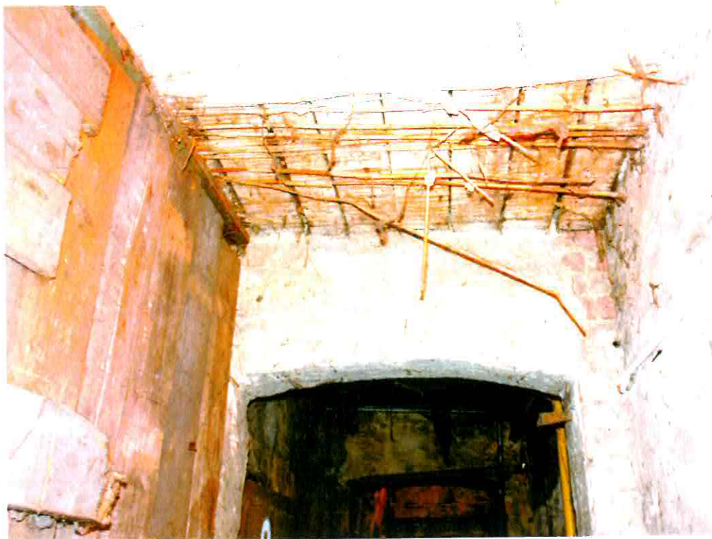
Fot. 18. Uszkodzenia tynku na suficie stropu piwnicznego
