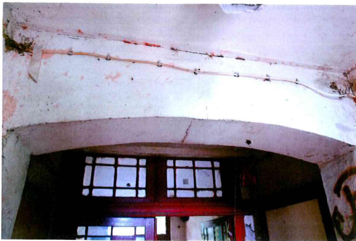
Fot. 10. Zarysowanie podciągu łukowego przy wejściu do budynku
