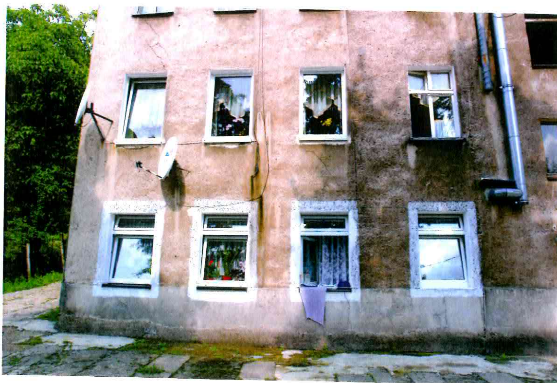
Fot. 6. Liczne zarysowania ściany zewnętrznej po lewej stronie klatki schodowej
