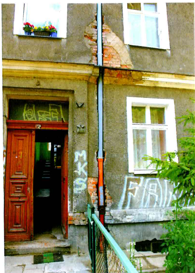
Fot. 8 i 9. Wejście do budynku od strony ulicy Lipowej (niedawno naprawiony pion odwodnieniowy)
