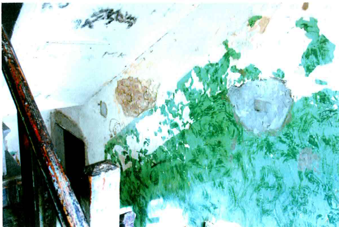
Fot. 23. Konieczne odnowienie klatki schodowej
